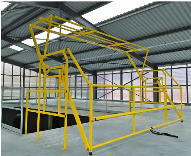
Typ BL: Ansicht von Bühne. Baubreite 4000mm, Bautiefe 2500mm, Absturzkante offen, Bühnenbereich gesichert
