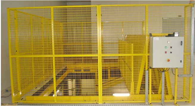
Die sich öffnende Luke sichert gleichzeitig den Eingang zum Schleusenraum. La trappe s'ouvrant sécurise en même temps l'entrée dans la zone de sas.
