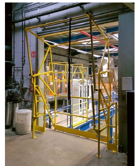
Schwensschleuse in der Anwendung mit Brandschutz-Schiebetüre
