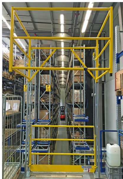
C1, Absturzkante gesichert, Schleusenraum offen.
