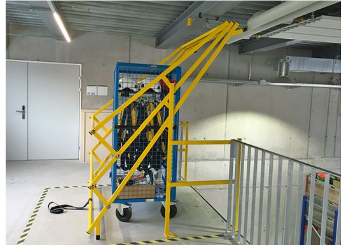
Absturzkante offen für Warenentnahme mit Stapler Sas ouvert pour l'enlèvement des marchandises
