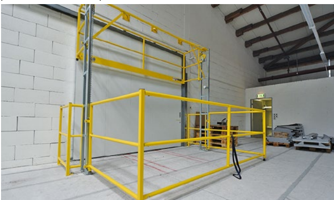
Platzierung vor Schiebetoren. Geschlossener Schleusenraum. Schiebtor von Hand nicht bedienbar.
