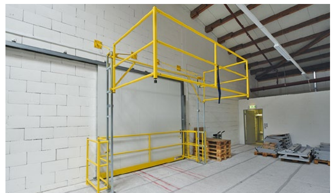
Abgesicherte Absturzkante, Schiebtor geschlossen. Schiebtor könnte jetzt von Hand geöffnet werden.
