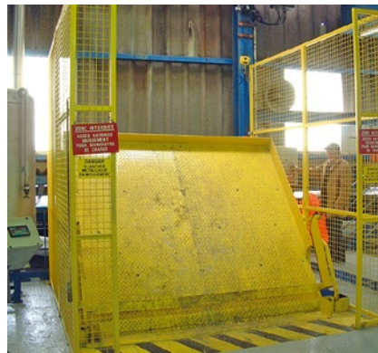
Bodenluke im sich öffnenden Zustand, der Zugang zum Schleusenraum wird geschlossen. Kein Zutritt mehr möglich. Trappe de plancher en position ouverte, l'accès à la zone de sas est fermé. Plus aucun accès possible.
