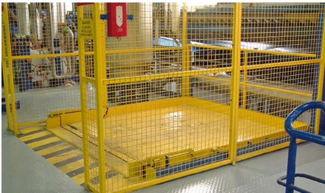
Bodenluke, die gleichzeitig als Abstellfläche verwendet werden kann um mit dem Kran aus dem oberen Geschoss die Güter zu fassen. Trappe de plancher pouvant être simultanément utilisée comme zone de stationnement afin de récupérer les marchandises de l'étage supérieur avec la grue.
