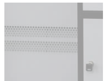
Lüftungsschlitze in der Rückwand sorgen für permanente Frischluftzufuhr.
