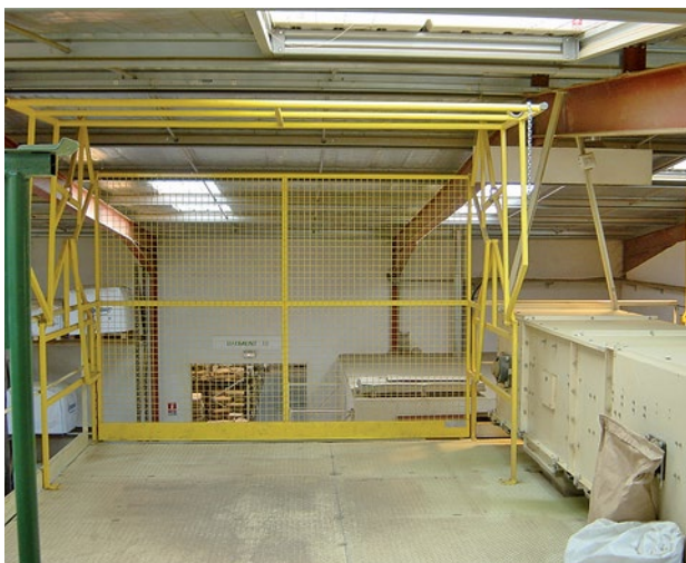
Ansicht von der Bühne – gesicherte Bühnenkante ▲
