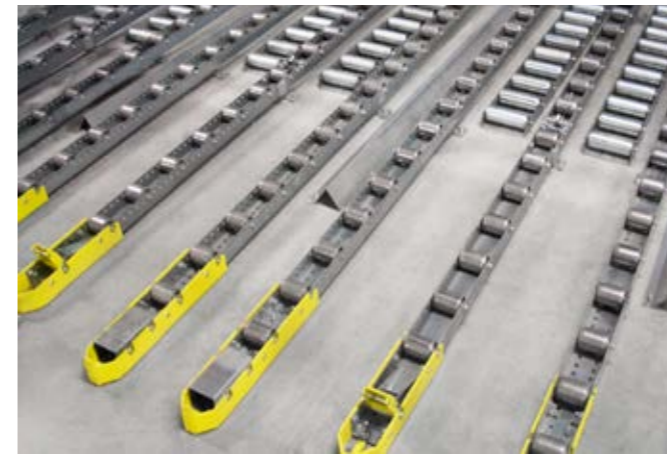
3-spurige Kommissionierbahnen mit RBG beschickt, Zutrittsverhinderung durch Rollenschienen und Trapezbleche, Trenneinrichtungen und Fußentriegelung
