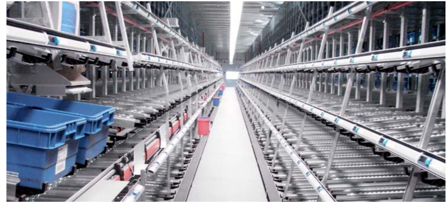
Durchlaufkanäle im Einplatz-AKL mit Wechselkanaltechnik
